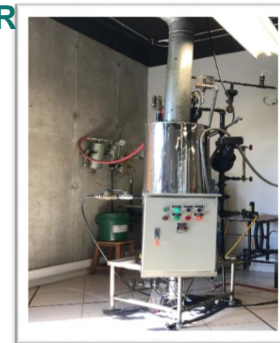
Caldera de gas natural Laboratorio Máquinas y Sistemas Térmicos UNAL.
